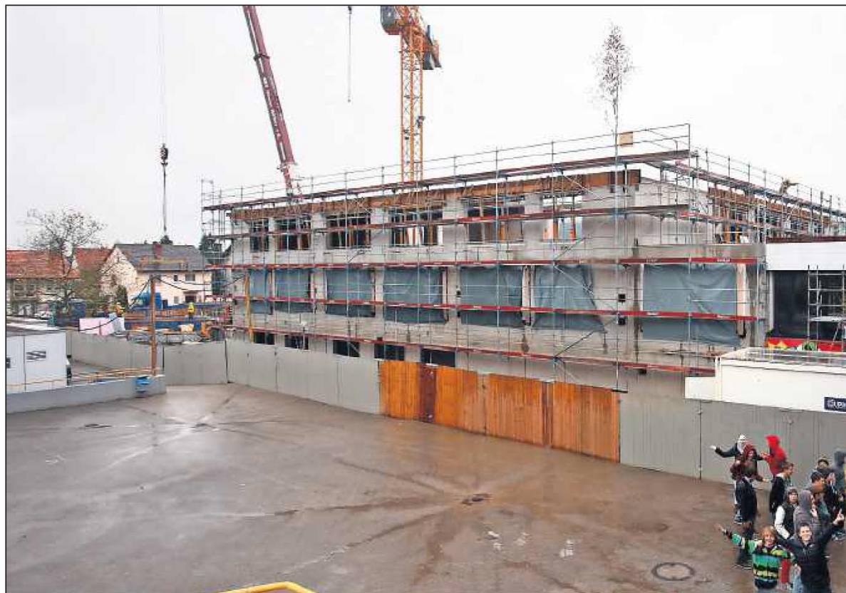
Vor knapp einem Jahr war Richtfest am Neubau der IGS Rülzheim. Seit Schuljahresbeginn wird im Gebäude unterrichtet
